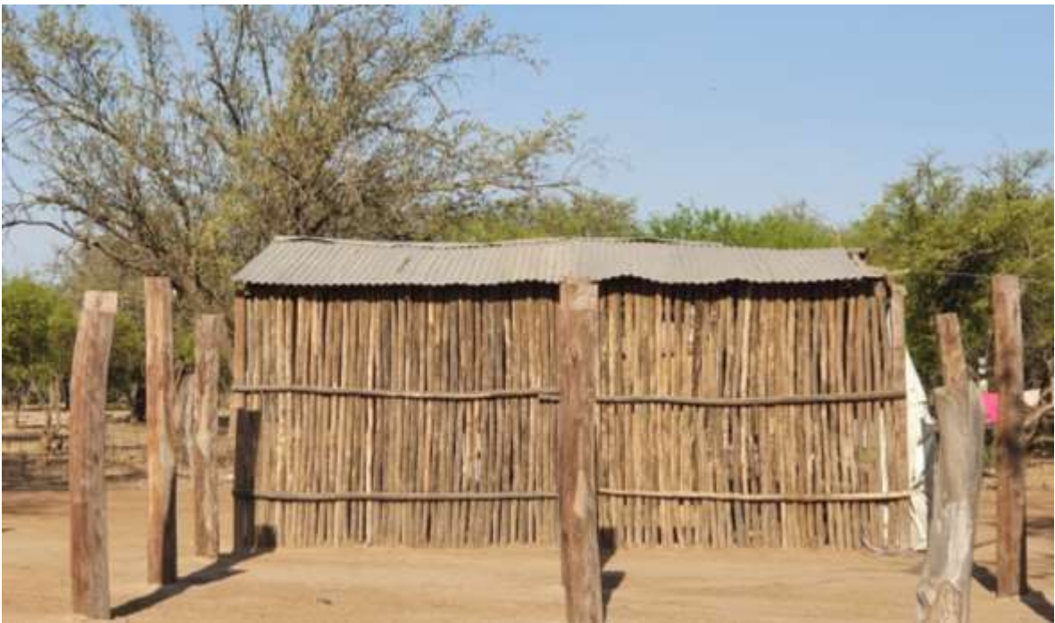
Figura 69 Vivienda de madera construida con la especie Palo Bobo / Aliso de río / Suncho ( Tessaria integrifolia ). Todas las construcciones de vivienda están hechas a partir de la especie. Mbuibé (en guaraní), Hábitat: orillas de ríos y arroyos, hasta 1500 msnm.
