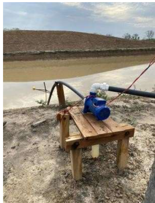
Figura 44. Motor del tajamar nuevo
