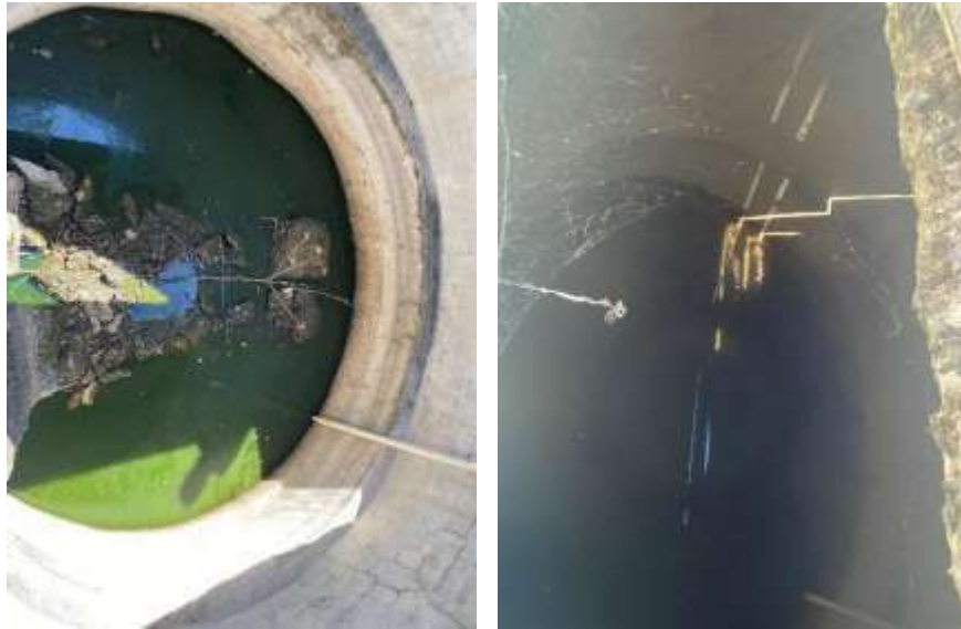
Figura 25. Estado de los dos aljibes del tinglado
