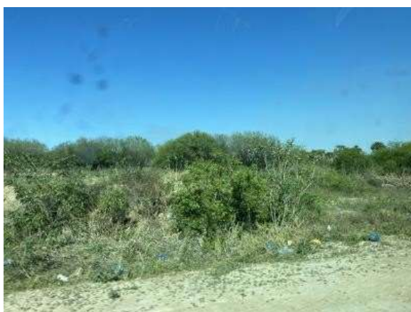
Figura 47. Colmatación y cobertura de vegetación del tajamar
