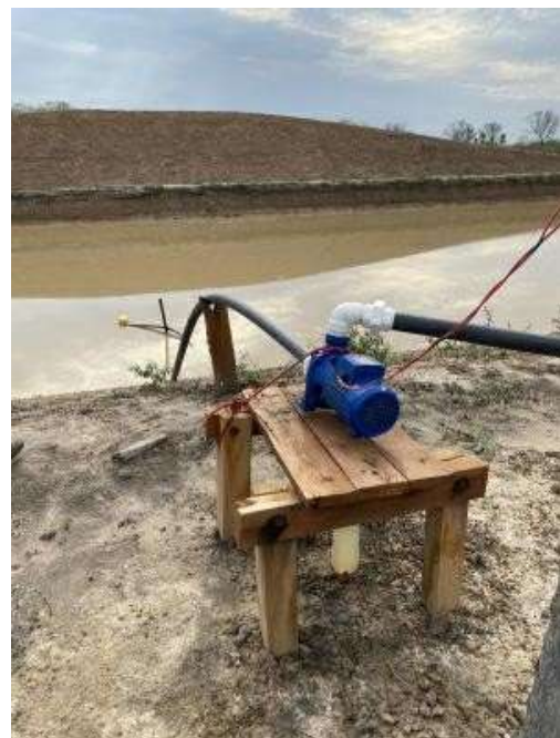
Figura 44. Motor del tajamar nuevo
