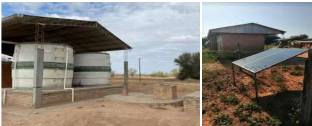
Figura 4. Dos tanques Syopar que no funcionan y un panel solar en la aldea San Ramón
