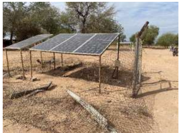
Figura 14. Paneles solares en San Pío X
