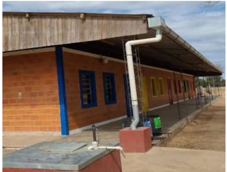
Figura 33. Sistema de recolección de agua de lluvia en la escuela
