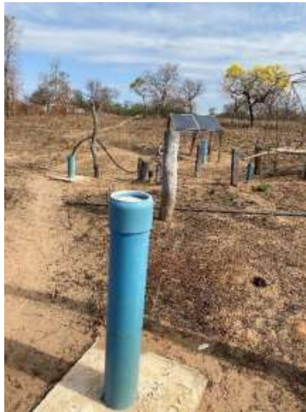
Figura 32. Pozo somero en Jotoicha, abastece a la escuela
