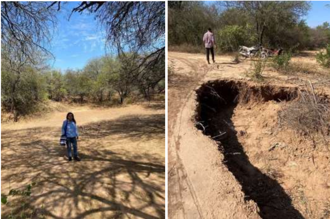
Figura 28. Tajamar CL 17 completamente seco, de 30 m x 40 m, con mucha colmatación
