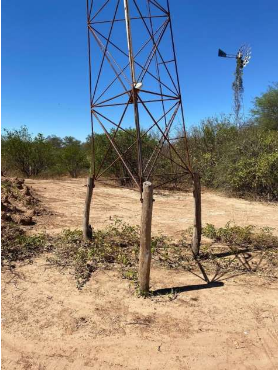
Figura 54. Soportes mal contruidos de los molinos, CL 20, San Miguel
