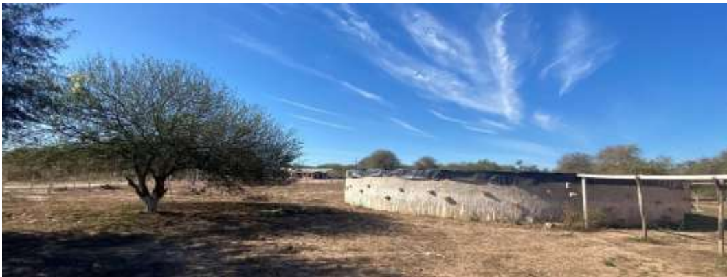
Figura 72. Tanque de 500.000 litros de la iglesia en General Díaz
