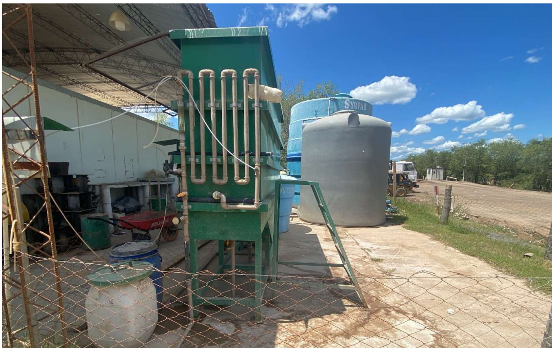
Figura 2. Planta compacta de potabilización (Foto Álvarez)
