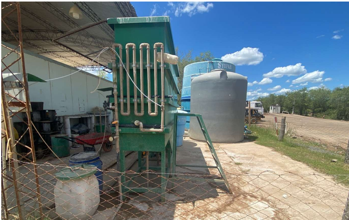
Figura 2. Planta compacta de potabilización (Foto Álvarez)
