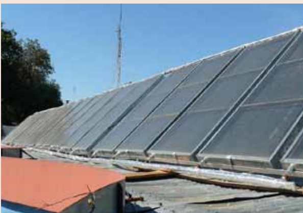
Colectores solares planos de un motel en Asunción.
