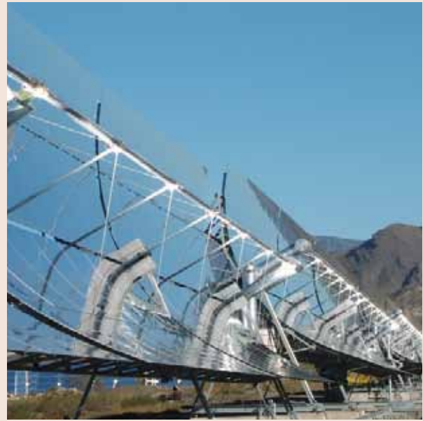
Central solar térmica con canales parabólicos.
