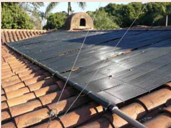
Colector solar plano sin cobertura transparente para climatización de piscina.
